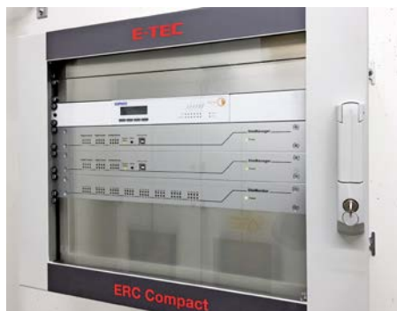
Bild 2: Das Monitoring-System überwacht die gesamte Infrastruktur einschließlich der Oasis-Systeme.
