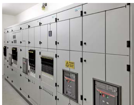
Bild 3: Vier Niederspannungshauptverteilungen (NSHV) versorgen auch die Klimasysteme.
