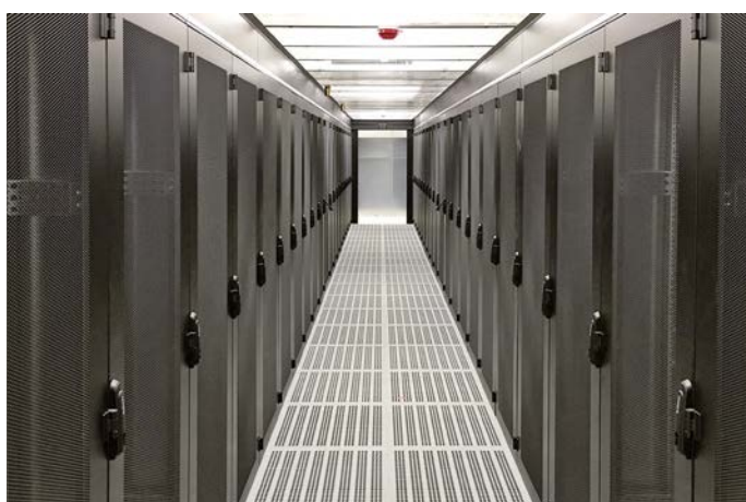
Bild 1: 320 Stück 19-Zoll-Serverracks sind in den Serverräumen untergebracht.
